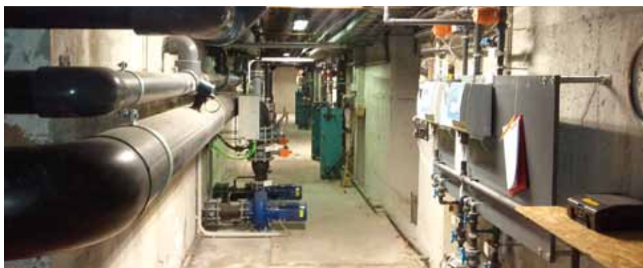
Einblick in das Innenleben des AquaForums, wo für beste Wasserqualität gesorgt wird.
